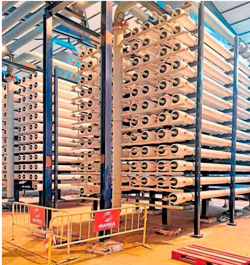
Imagen de algunos de los nuevos elementos filtrantes en la desaladora de Marbella. SUR
