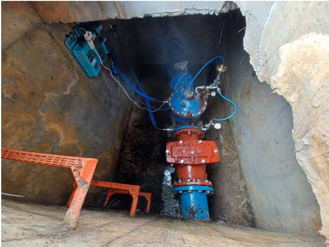
El automatismo instalado en la red de suministro.
