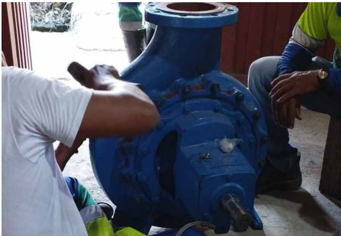
Sistema de bombeo de Aqualia // Foto: captura de pantalla.
